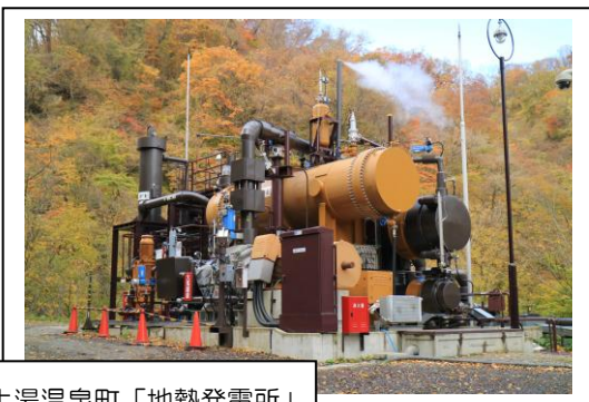
土湯温泉町「地熱発電所」
