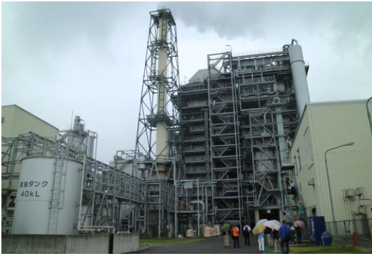
川崎バイオマス発電所
